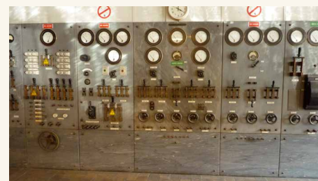
3. Tableau de distribution électrique © N. Gesché-Koning
